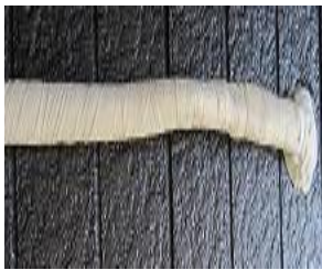
エアコン配管
